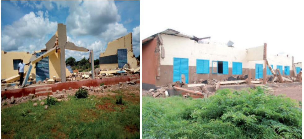
Graphique 4 : Quelques cas d'ouvrages de mauvaise qualité
