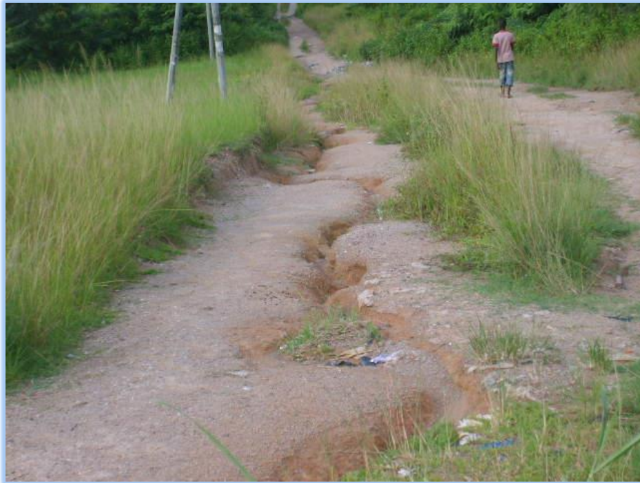
Photo 3: Voirie dégradée et bouchée à l'intérieur de quartier Crédit photo :Niamké Joël,2016
