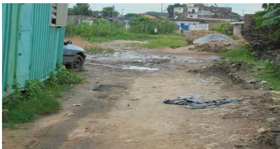
Photo 4: Voie dégradée à l'intérieur de quartier à Tiassalé
